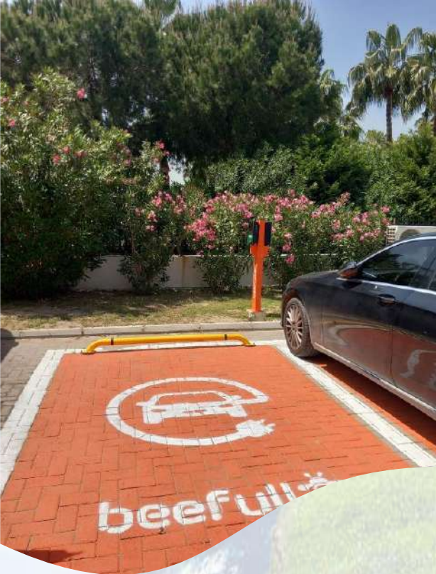
Elektrikli Araç Şarj İstasyonları
